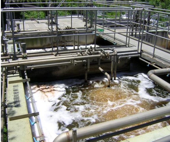
<接触曝気槽第1室>
